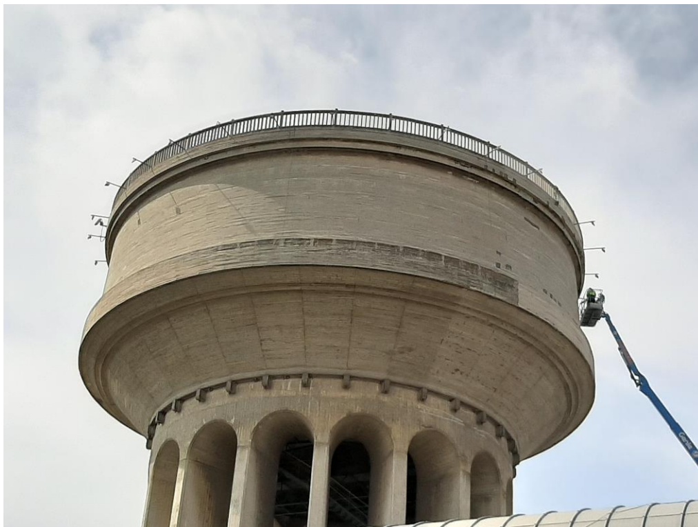
Preparación de la superficie: limpieza con chorro de agua a alta presión / Surface preparation: cleaning with high-pressure water jet
